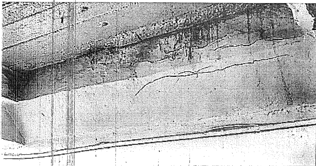
Fotografia numer 9. Widok na miejsce numer 3 z widocznym przeciekiem i korozją zbrojenia.
