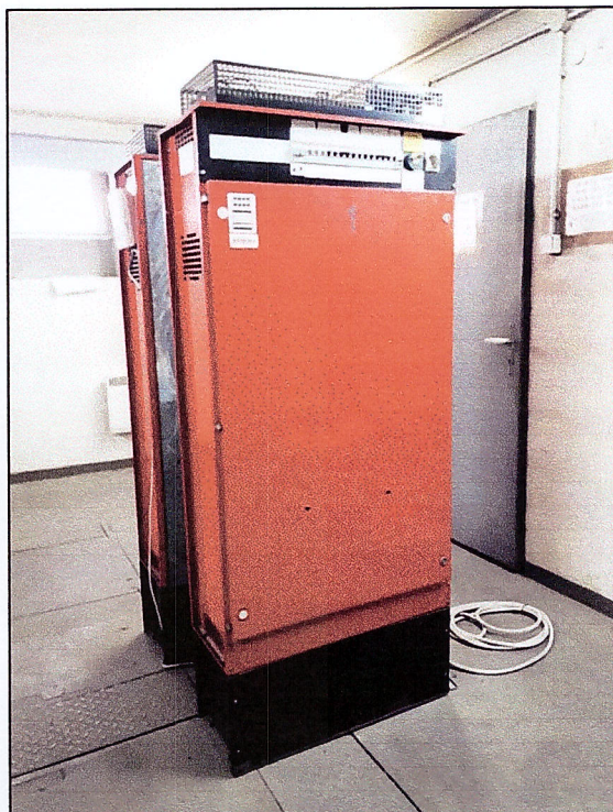
Tablice sterowe dźwigów (nr 2 w głębi)
